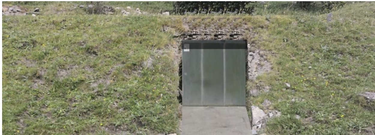
Exemple d'accés a caseta de bombes integrada al dic
