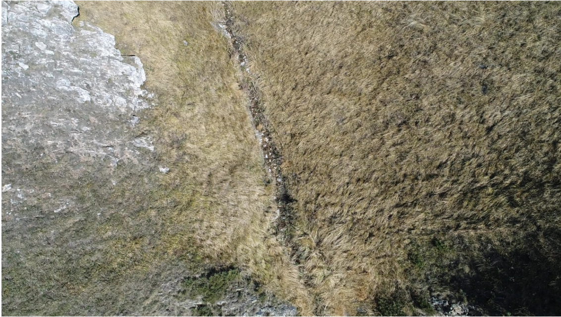
Imatge 2: vista de l'erosió del torrent en fons de canal, amb el seu encaixament.
