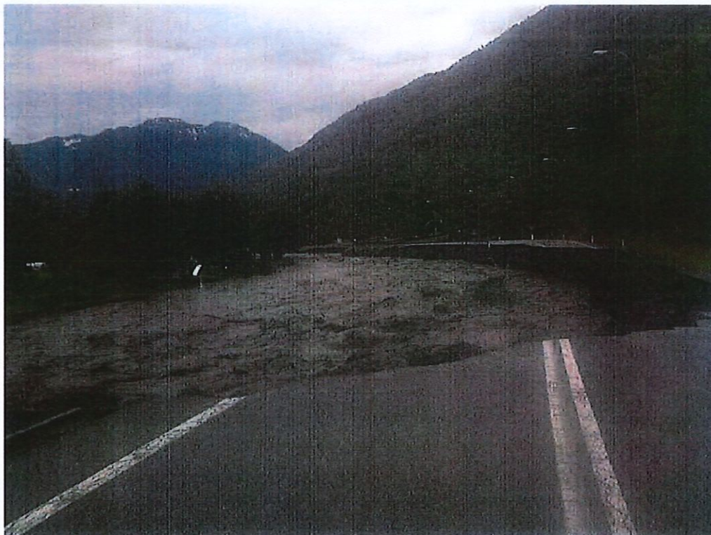
Afectación a la N230 en Les
