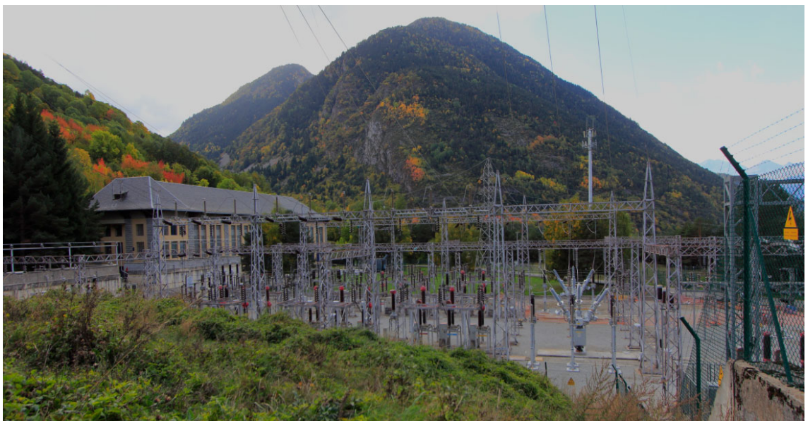
Subestació elèctrica de la Central d'Aries amb l'edifici a l'esquerra.
