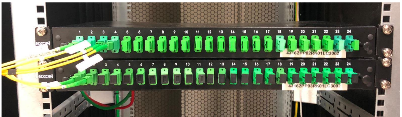
Patch Pannels 24 posicions SC/APC Hospitalet del Infant
