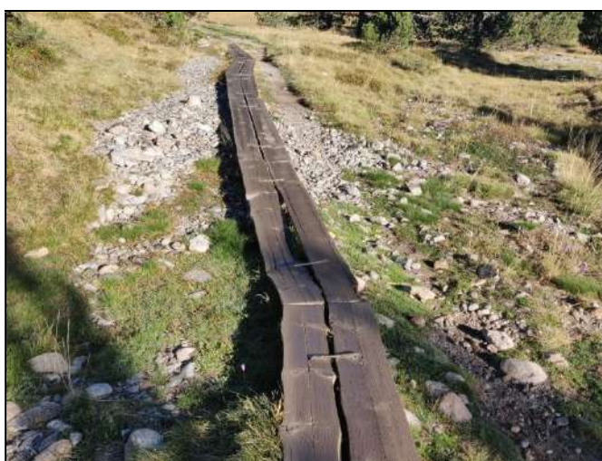
Imatge 4. Tram de passarel·les amb les unions trencades.
