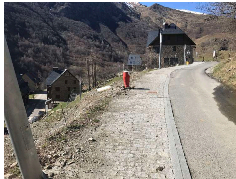
Foto 9 Detall d'hidrant al vial de l'eix 1, a l'alçada de l'entroncament amb l'eix 2.
