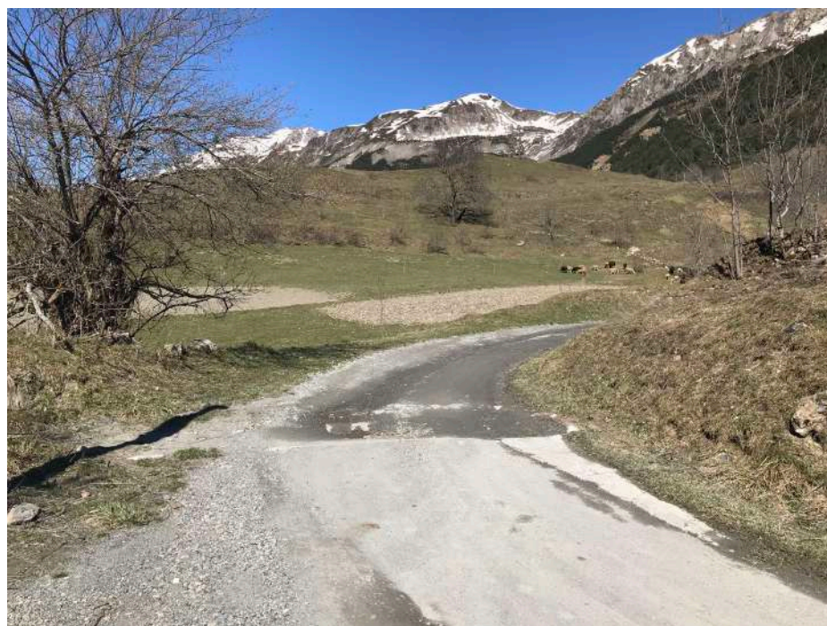
Foto 4 Final de la part pavimentada del vial de l'eix 1, compartit amb el Pla Parcial 1, que continua sense pavimentar fins al Pla de Beret.
