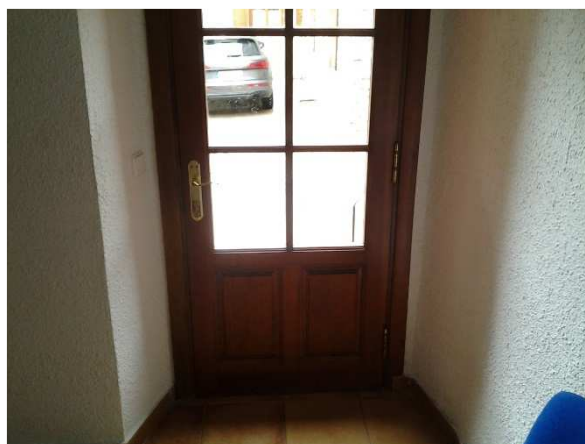
Imatge 3. Imatge interior de les parets existent en el dispensari mèdic, on es pot observar el goteler.
