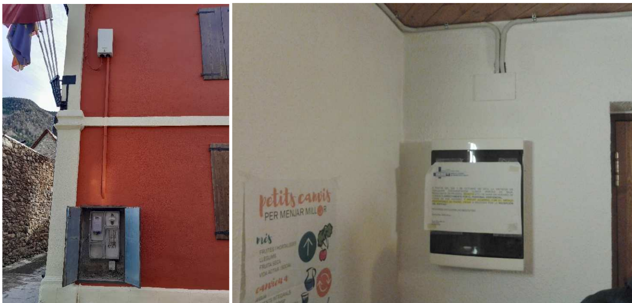
Imatges 11 i 12. Armari encastat amb la unitat de comptatge de l'edifici de l'E.M.D. (esquerra), i subquadre elèctric existent en l'interior del dispensari mèdic (dreta).
