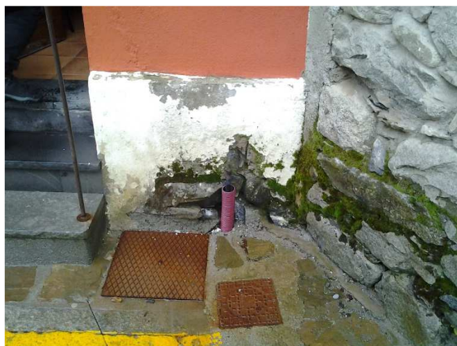
Imatge 15. Escomesa de gas propà existent pel subministrament de gas al dispensari mèdic.
