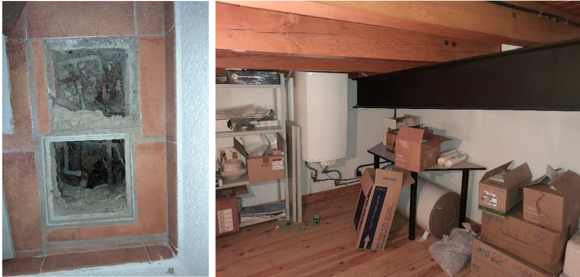
Imatges 9 i 10. Vàlvula general de tall d'aigua ubicada en un pericó al sòl del vestíbul del dispensari (esquerra), i escalfador elèctric pe producció d'ACS ubicat en l'altell (dreta).
