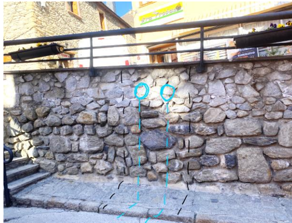
Bajada para alimentar el ayuntamiento desde la calle Sant Andrèu hasta la calle Balmes.
