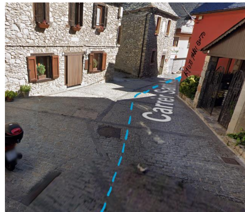
Discurrimos por la calle Sant Andreu con la tubería hasta la zona de la iglesia.
