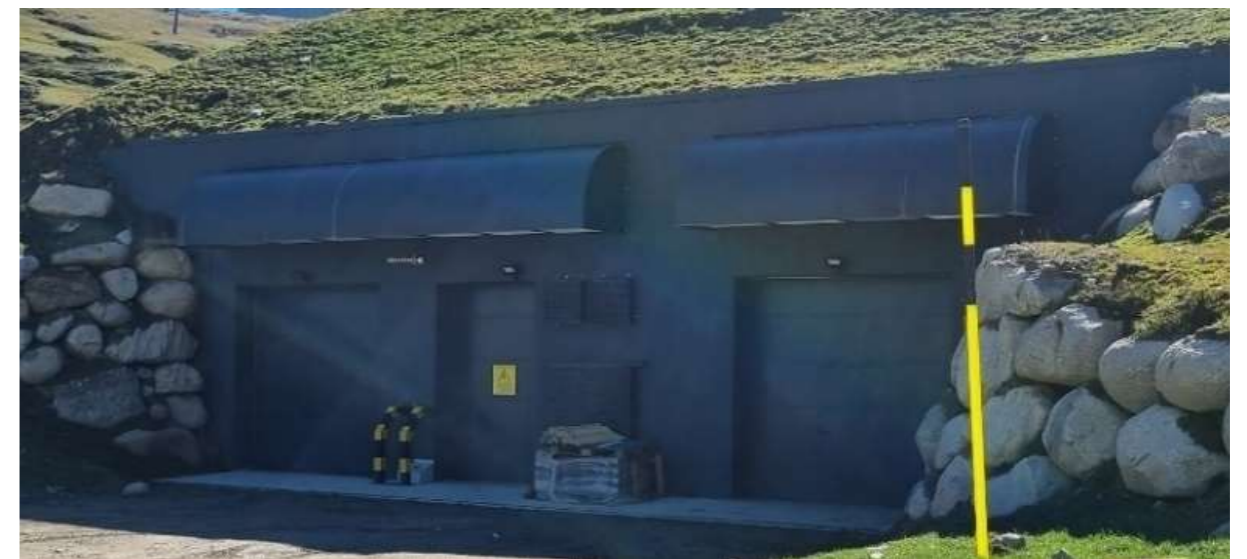
Exemple de sala de bombeig de la bassa beret
