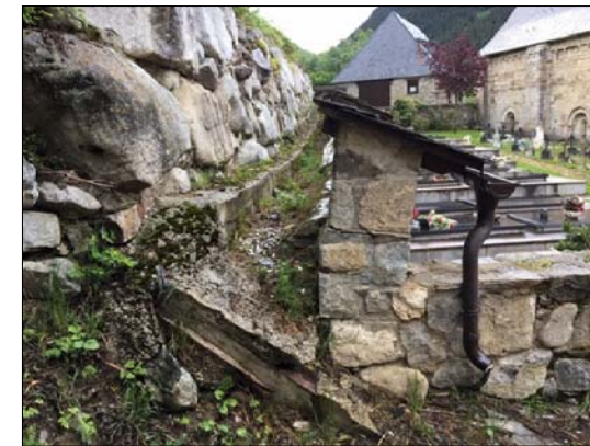
DESPLOME MURO MAMPOSTERIA
