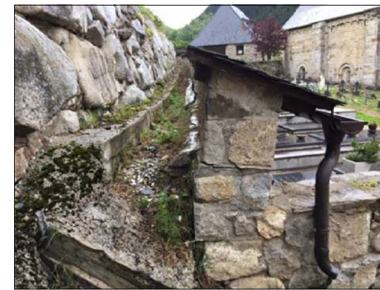
DESPLOME MURO MAMPOSTERIA
