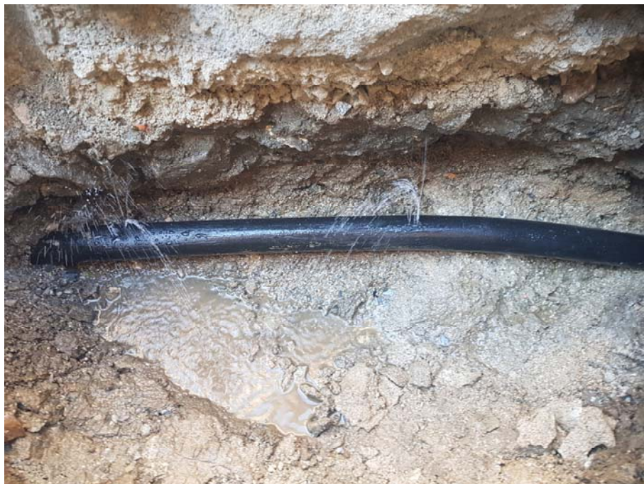
Imatge 1 Estat actual canonada
