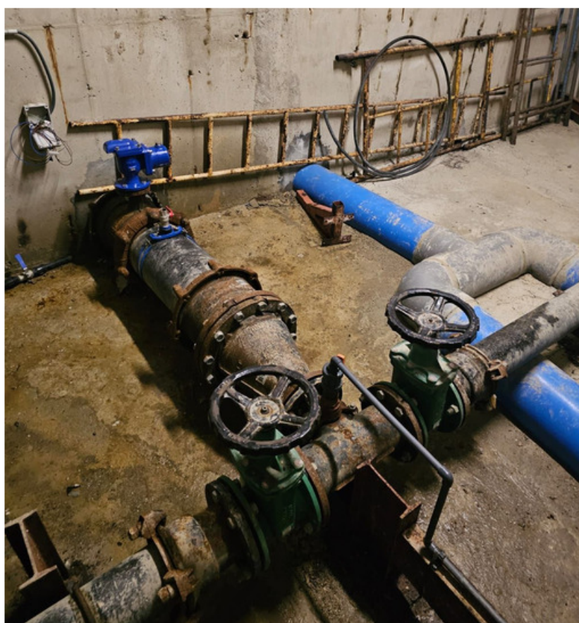
Canonada fundició DN300 sortida dipòsit cota 1.500
