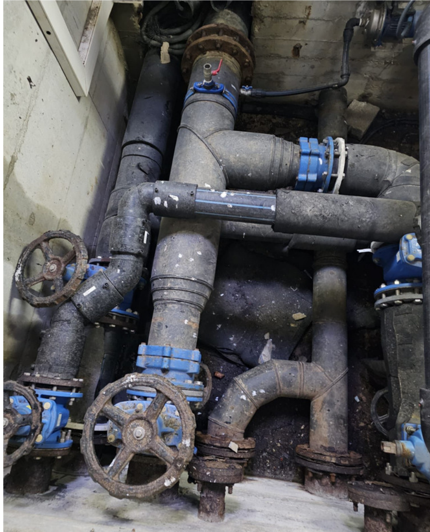
Canonada fundició DN300 sortida dipòsit cota 1.700
