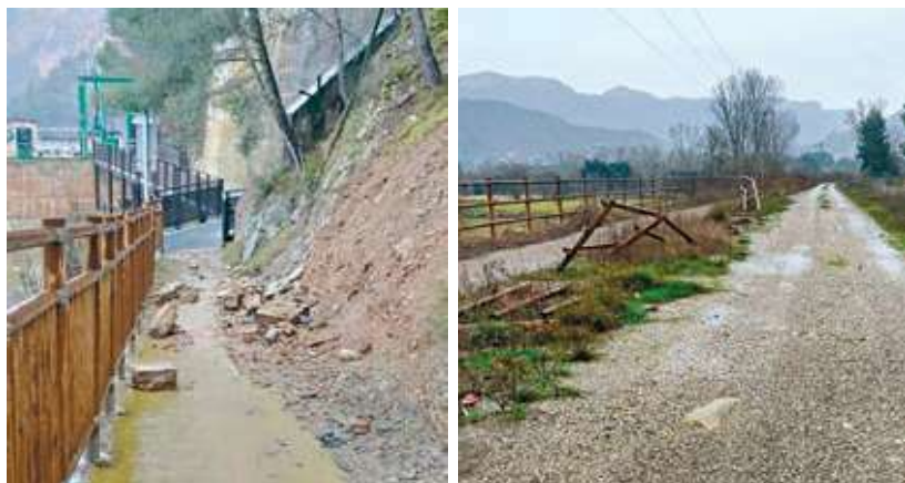
FOTO_ L.M. A l'esquerra, alguns desprendiments. A la dreta, la tanca trencada
