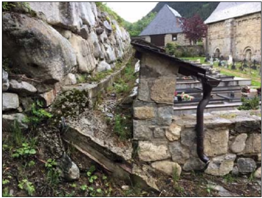
DESPLOME MURO MAMPOSTERIA
