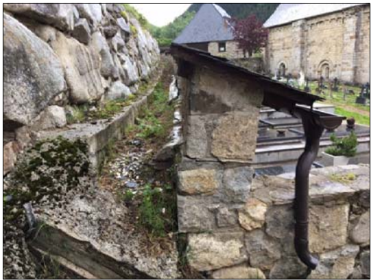
DESPLOME MURO MAMPOSTERIA
