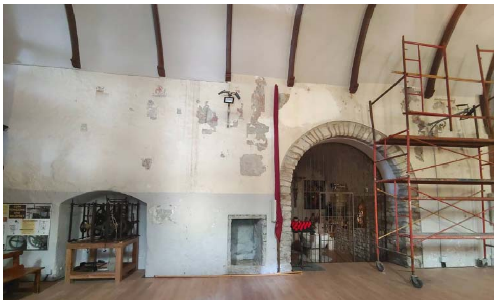
La paret nord abans de la intervenció de la fase 1
