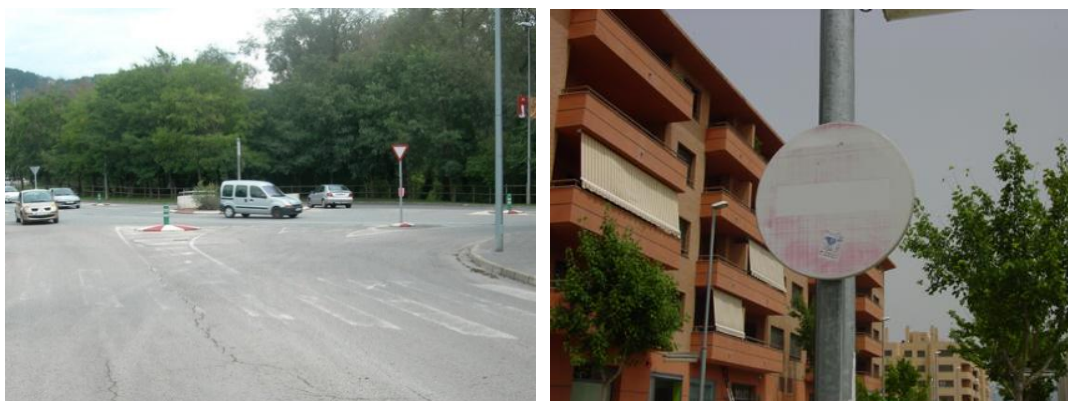
Imatge 49. Senyalització en estat deficient
